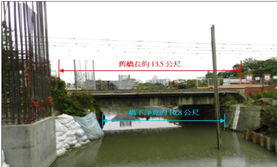
照片 1 102 年番仔溝橋現況，拍攝角度係由嘉義市政府中央排水上游往下游拍攝，照片中左側鋼筋混凝土結構物為興建中跨越鐵路之嘉義市垂楊陸橋橋柱。
