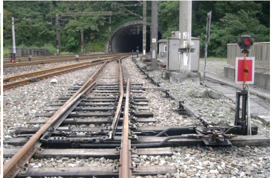
照片 10、脫軌道岔-東澳站 19B 號道岔
