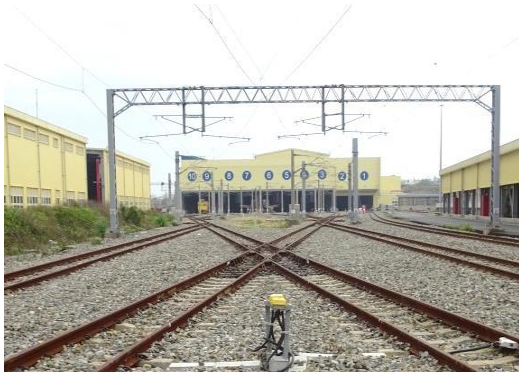
照片 11、菱形道岔-富岡基地站 501AB、502AB 號道岔
