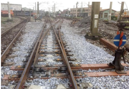
照片 4、右開道岔-花蓮站 305 號關節式道岔
