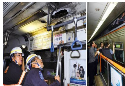
圖 7 車廂受損情形【17】
