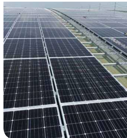
▲潮州車輛基地屋頂光電板
