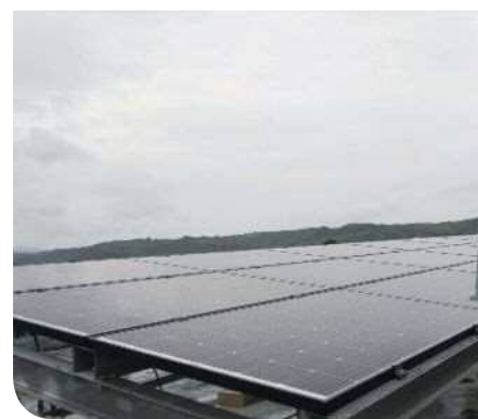
▲附業營運中心臺東工作站屋頂太陽光電板
