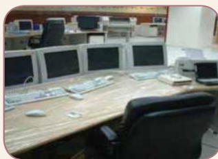
調度領班臺，可監控調度員調度情形及列車資訊、運轉計畫製作。
