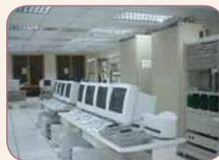
中央行車控制技術員臺，一方面監視全區間運轉設備的動作及列車的運轉狀態，一方面操控各站的號誌機及轉轍器
