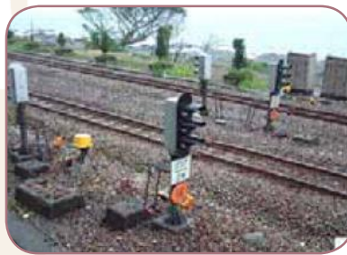
計軸器現場安裝配置
