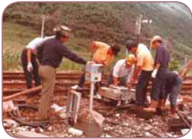
電動轉轍器安裝情形
