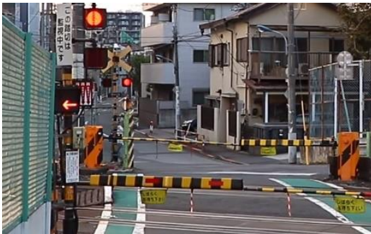
[A] 山手線－第二中里平交道大型遮斷裝置
