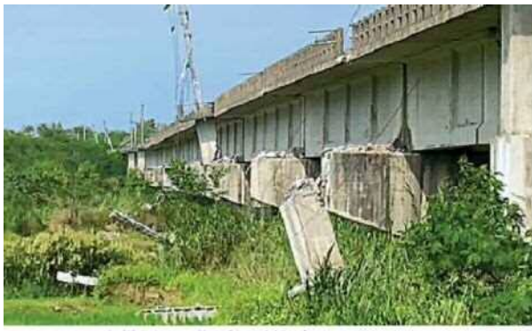
▲臺鐵新秀姑巒溪橋墩柱受損
