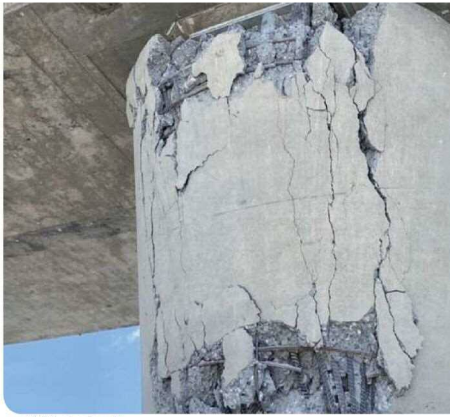
▲臺鐵樂樂溪橋受損墩柱
