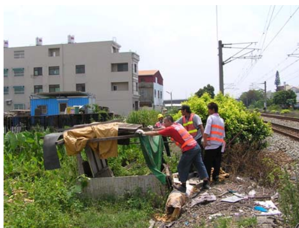
公告期滿後強制拆除
