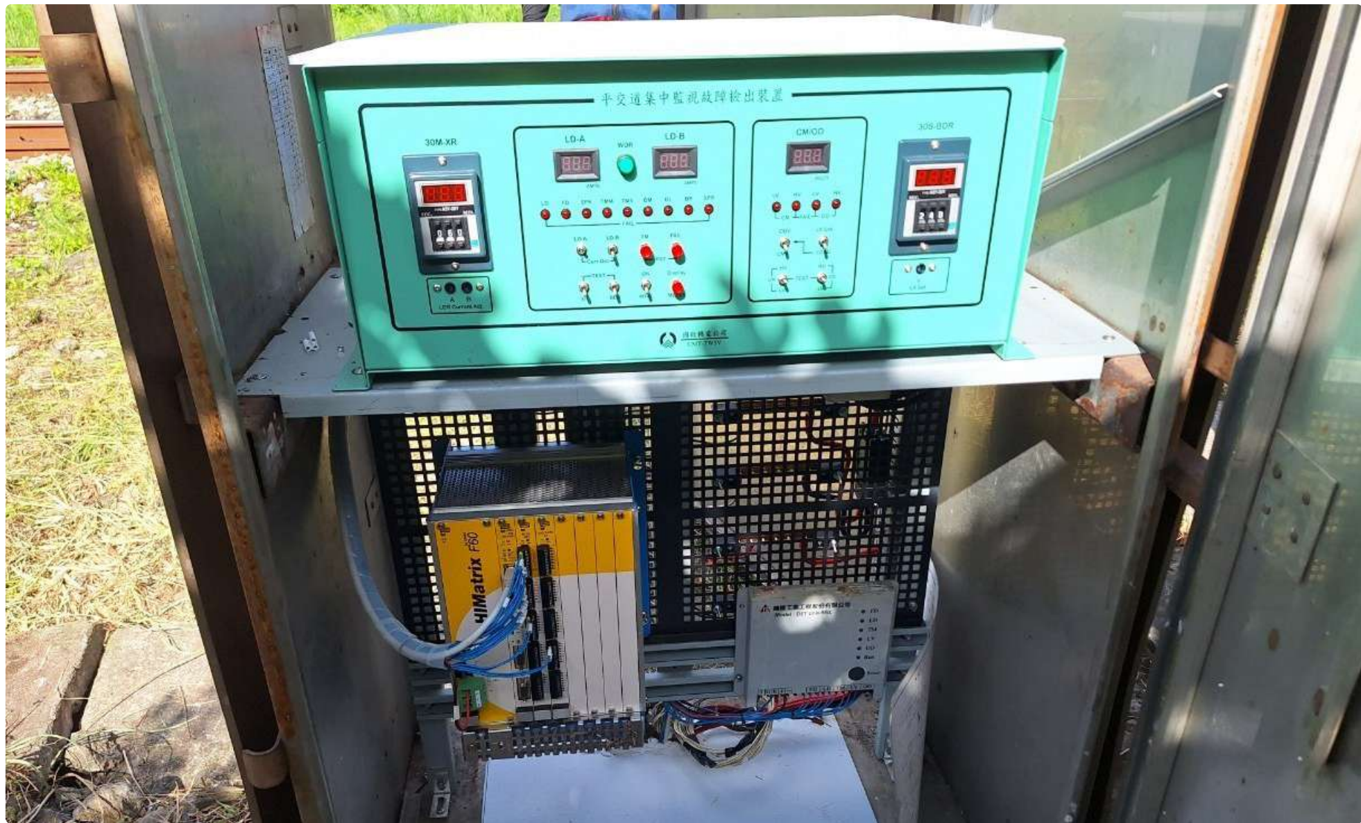
平交道集中監視 (CMT) 故障檢出組
