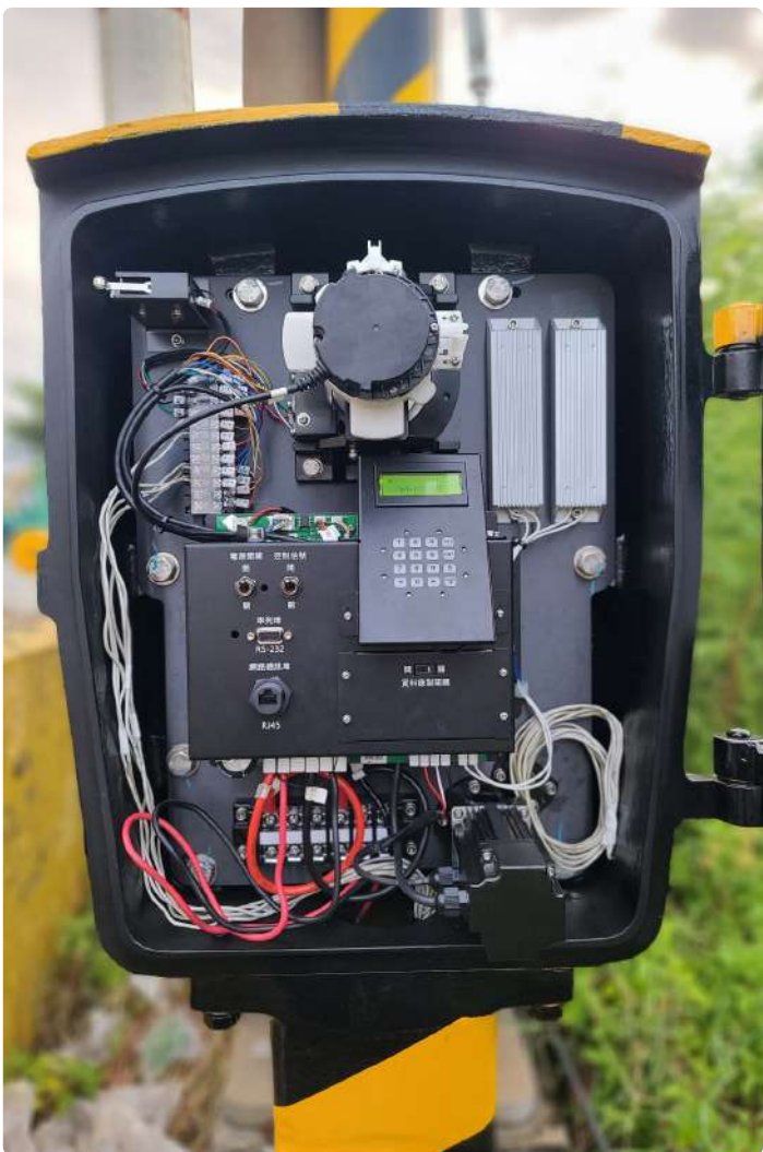
遮斷機內部全貌
