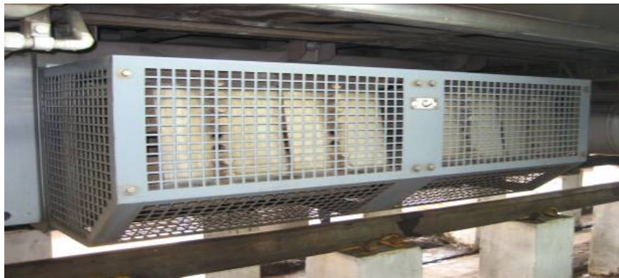
圖 4 安置在牽引轉換器之熱管式模組
