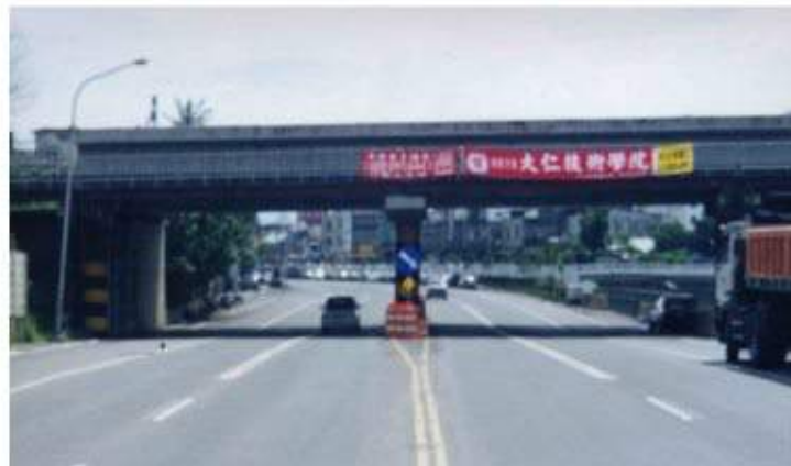
照片 3-20 屏東線跨萬年溪及自由路的 U 型預力樑橋完工後
