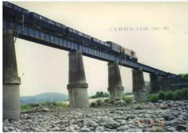
照片 3-34 因河床下降而露出的沉箱基礎
