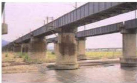
照片 7-17 雙軌後之濁水溪橋 (左邊橋梁 1927 年完成、 右邊橋梁 1970 年完成)
