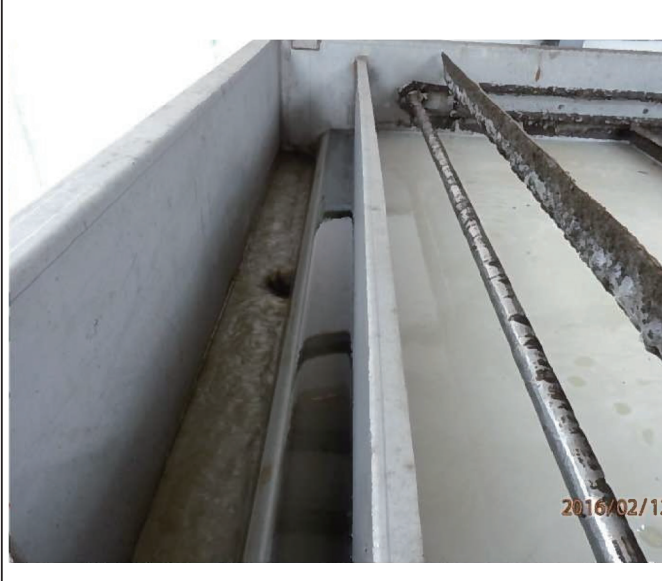
圖 5 刮渣板去除浮渣
