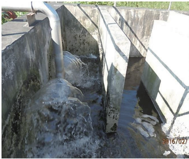
圖 10 處理後水排放
