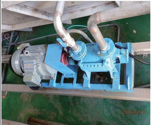
圖 11 循環泵建立浮除設備壓力
