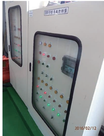
圖 13 加壓浮除設備配電盤
