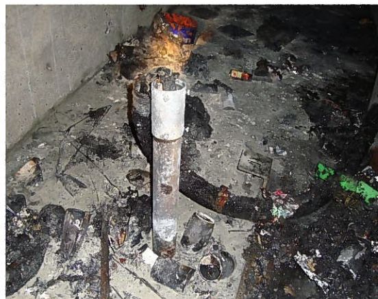
圖 6 火災燒毀情形
