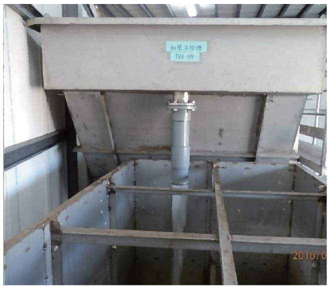
圖 7 去除浮渣之處理水槽外觀
