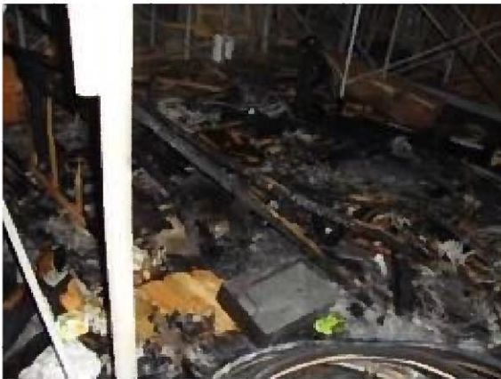
圖 10 火災燒毀情形
