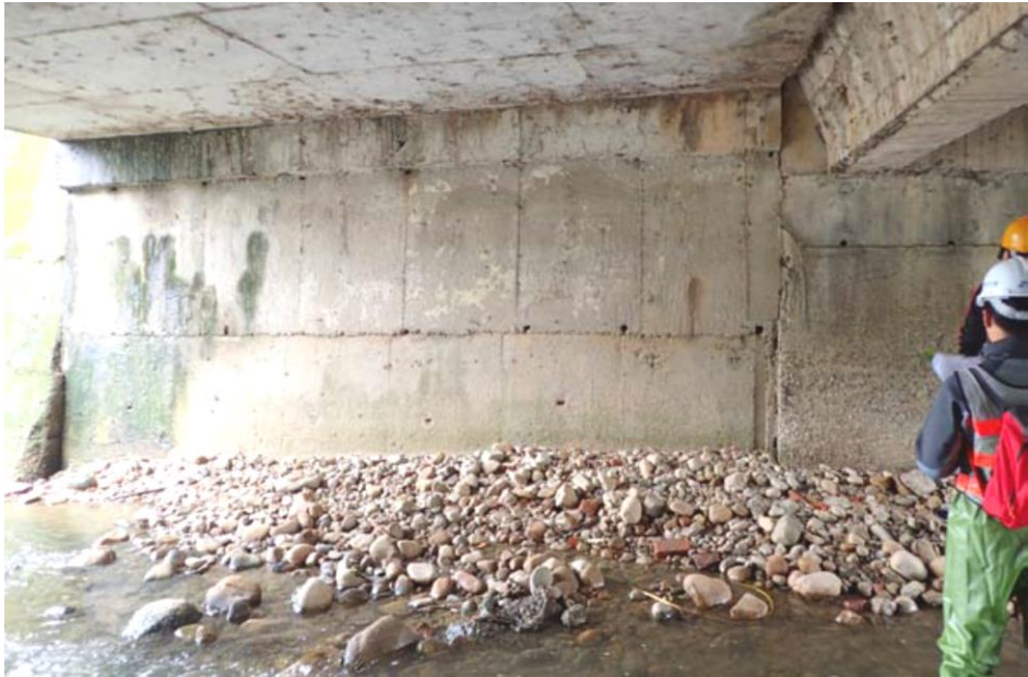
圖 5 近端橋台發現裂縫
