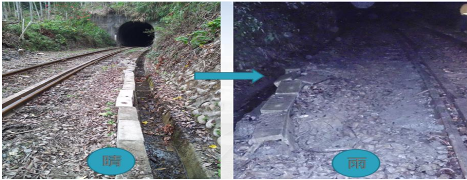
圖12. 集集支線1號隧道南口排水設施不良示意圖
