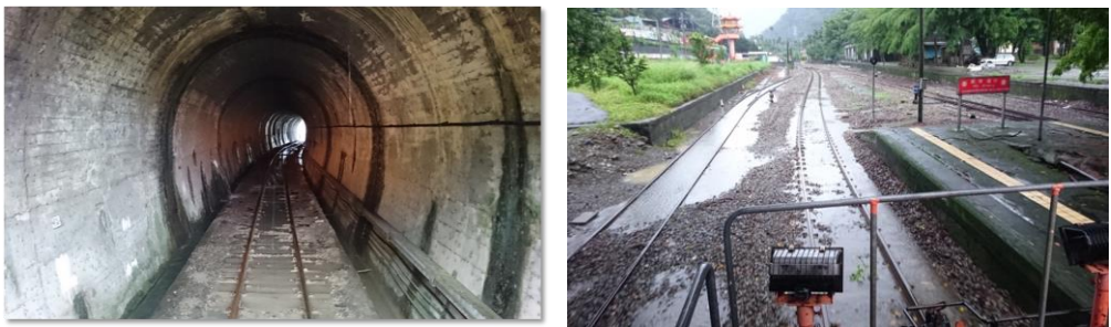
圖14.集集支線中興隧道、水里站排水設施不良示意圖
