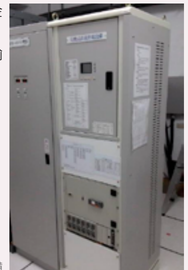
花蓮電務段交換式直流供電設備
