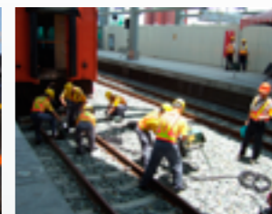
104.7.9 高雄區鐵安演習，列車出軌搶修演練情形
