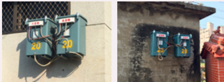
竹南 ~ 台南間變壓器改善
