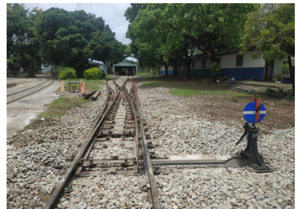
照片⑧ 實際鋪設 本案從發現問題、調查分析、研討改善到設計圖說，皆由臺鐵局同仁完成，並由國內廠商配合製作相關零件，已於 112 年 5 月鋪設於養護總隊場內軌道
