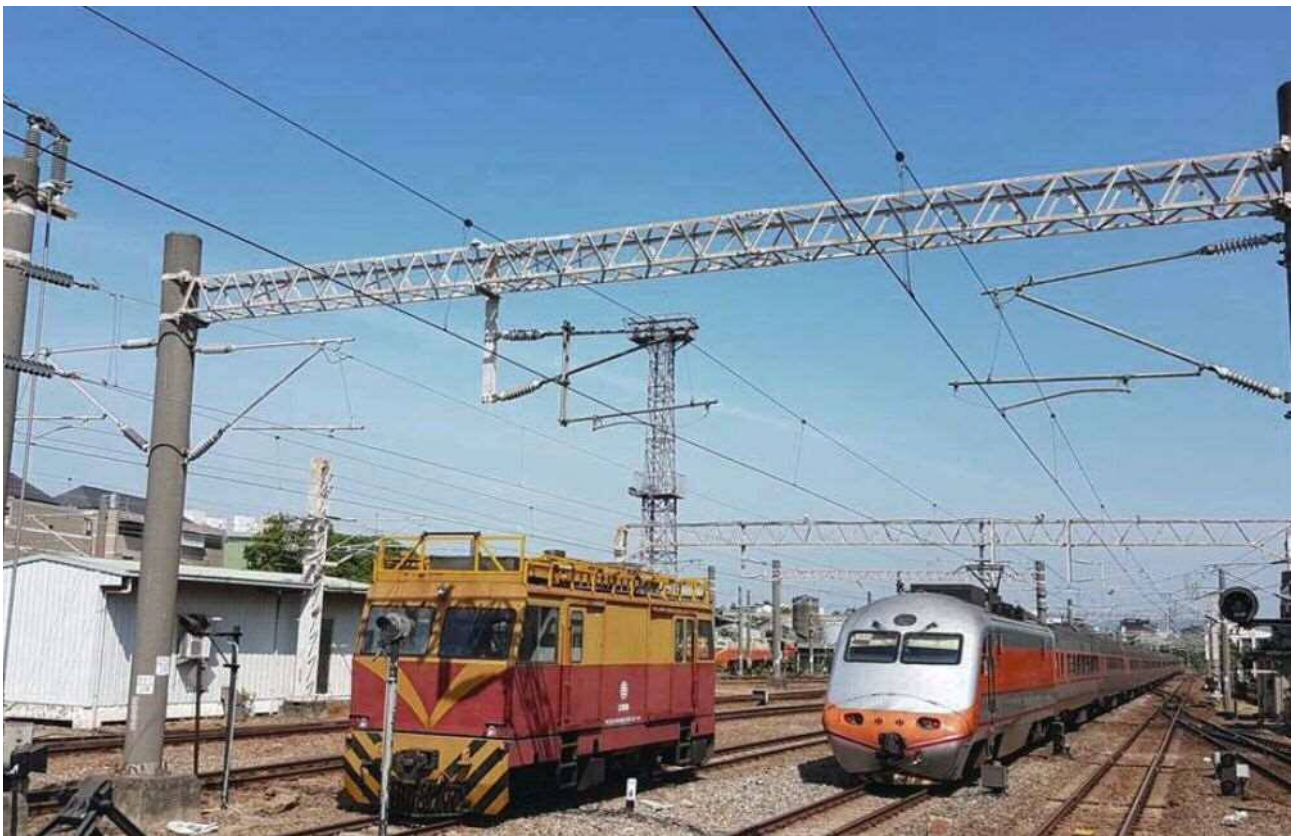
▲電車線系統 (95mm 2 主吊線)
