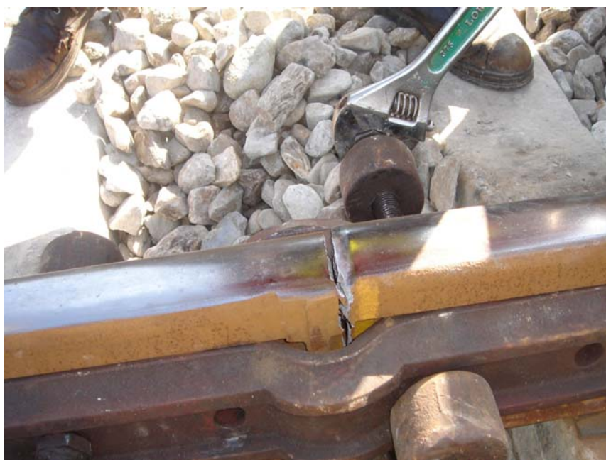
圖 3-21 鋼軌斷裂(b)
