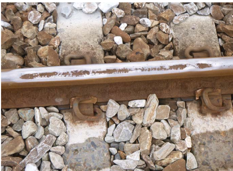
圖 3-19 車轍槽型波狀磨耗(c)
