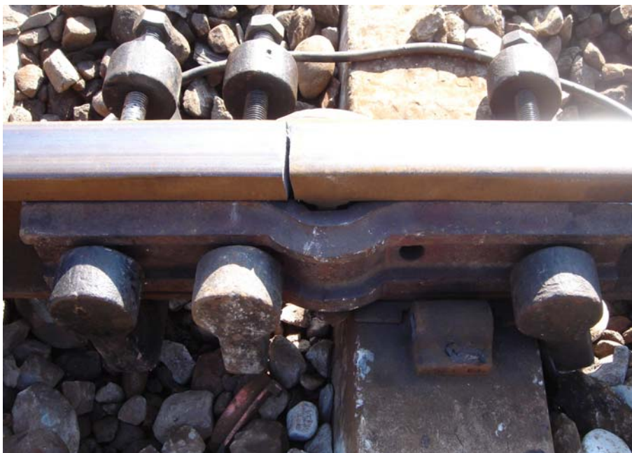
圖 3-20 鋼軌斷裂(a)
