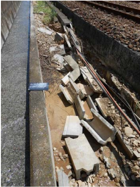
圖 3 電纜槽遭水流沖刷掏空底部
