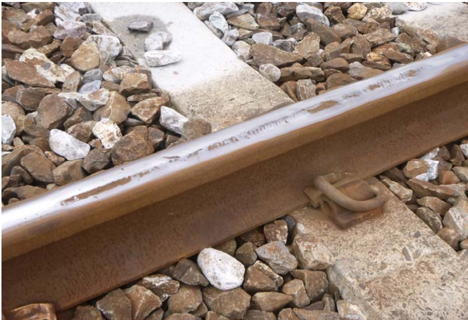
圖 3-17 車輪槽型波狀磨耗(a)
