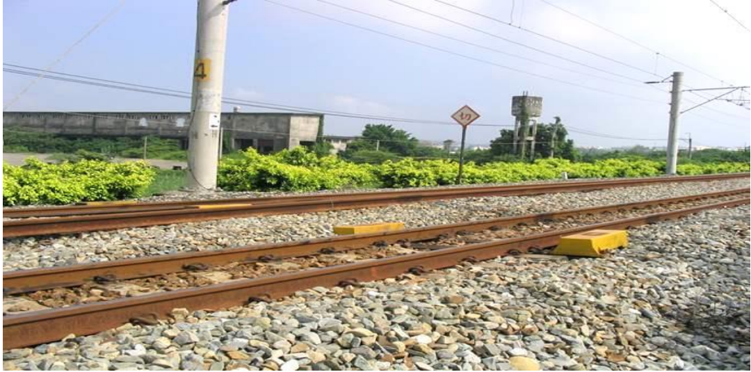
圖 4 路軌旁自動電力控制器(APC)現場照片
