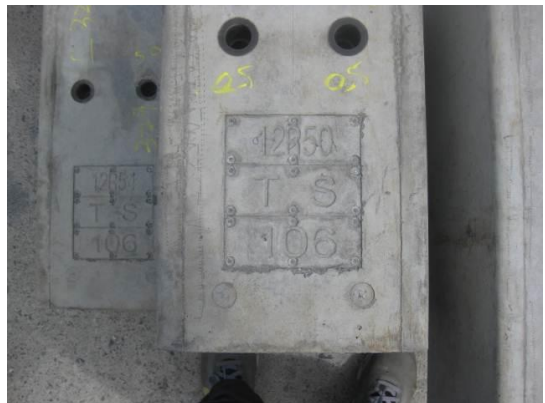
照片 7 PC 枕標示
