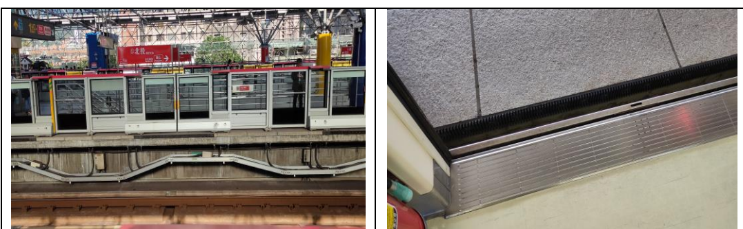
上下車門處未安裝橡膠材
