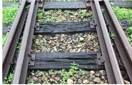
照片 2-2 腐朽枕木
