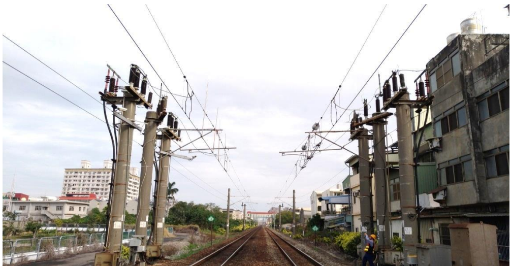
圖 3 彰化中性區間分相裝置現場相片
