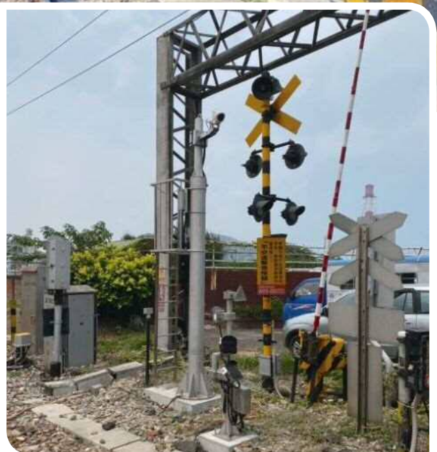
▲平交道防護各式設備
