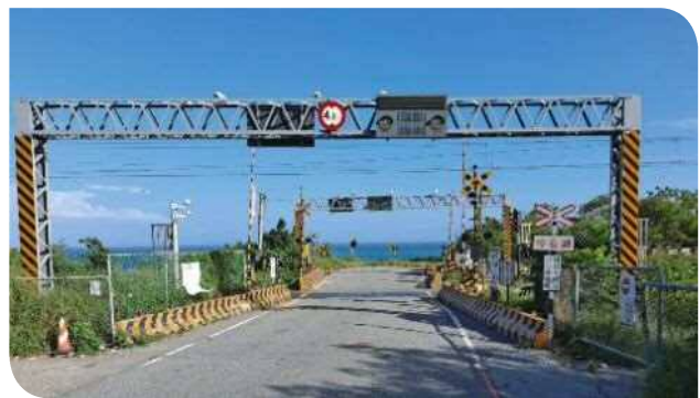
▲平交道周邊防護設備
