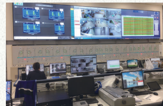
高雄站鐵路地下化中央監控室
