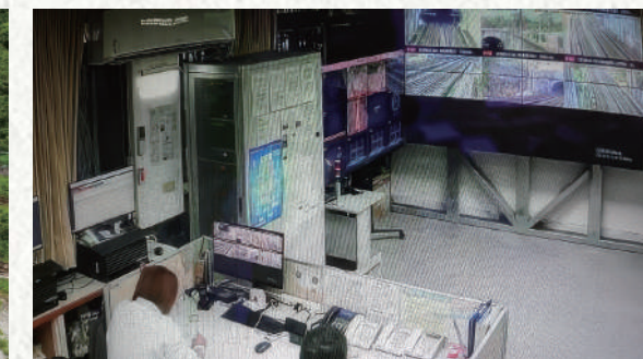
CCTV 設備值班室監控畫面
