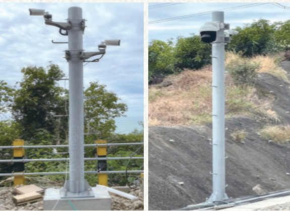
異物自動偵測系統 (含高桅桿、CCTV 聯接 AI 偵測系統)
