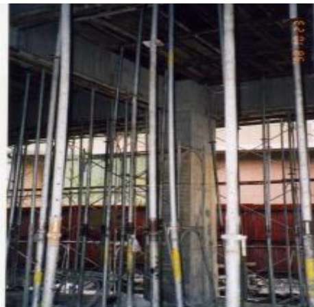
圖 21 有缺陷之可調鋼管支柱
