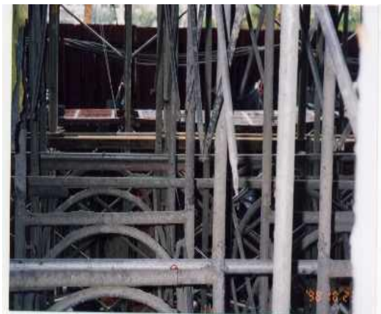
圖 22 交叉斜撐栓銷損壞
