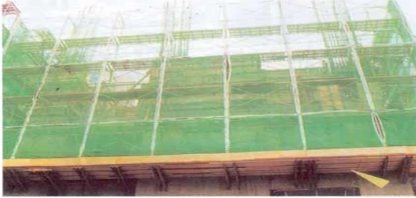
圖 17 施工架踏板應滿鋪，交叉斜桿下方設置中欄杆，端部應加設護欄
