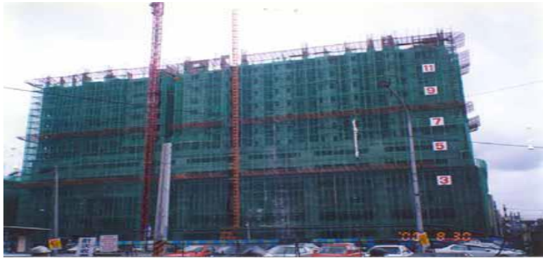
圖 18 築施工架時，有鄰近結構物之周遭或跨越工作走道者，應於其下方設計斜籬及防護網等，以防止物體飛落引起災害。
