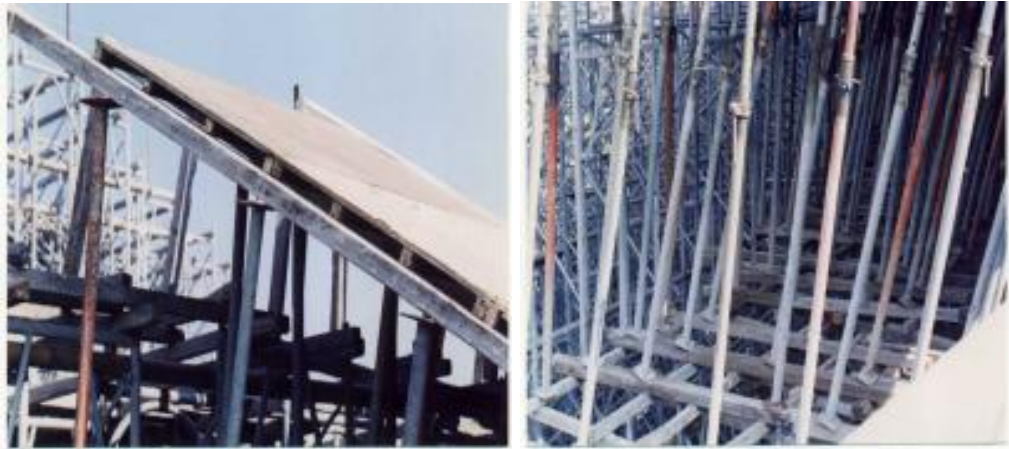
圖 23 桿件聯結處未設置適當防滑脫裝置
