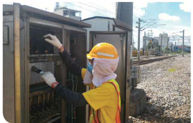
▲道旁號誌電氣箱保養
