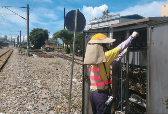
▲道旁電氣箱檢查
