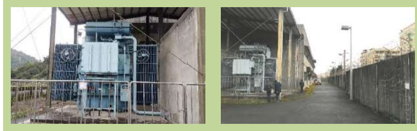
圖 2.5 臺鐵室內型變電站
