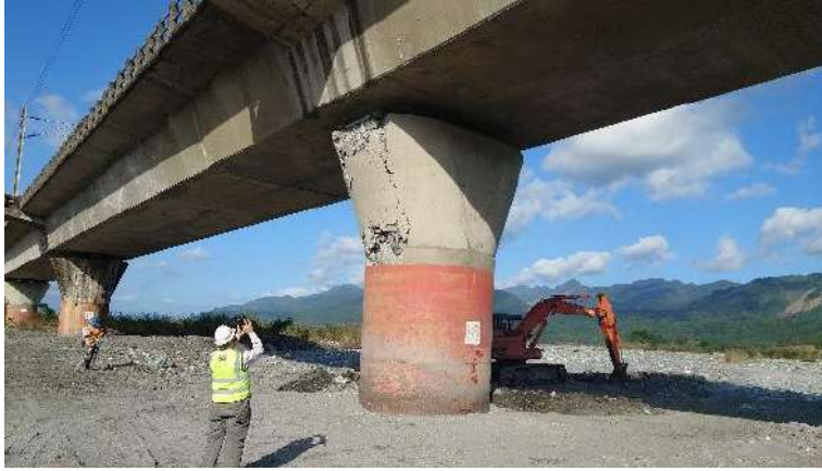
圖3-1 樂樂溪橋震後受損狀況(P16橋墩)
