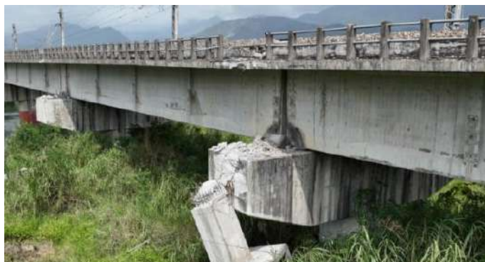
圖4-2 新秀姑巒溪橋震後受損狀況(P11橋墩西側)
