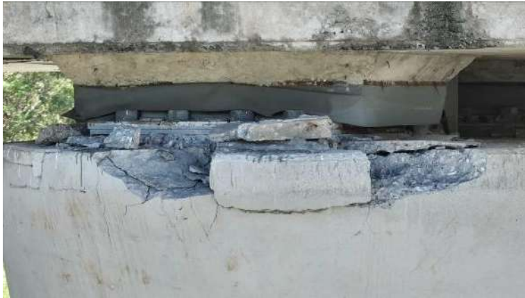
圖3-2 樂樂溪橋震後橋墩頂部受損狀況(P19橋墩)
