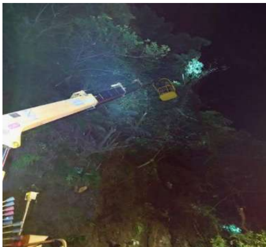
圖 2 平溪線上邊坡宜蘭段鄭姓工程司站在吊籠裡對影響木進行鋸枝 (宜蘭工務段 2022 年 6 月 9 日攝)
