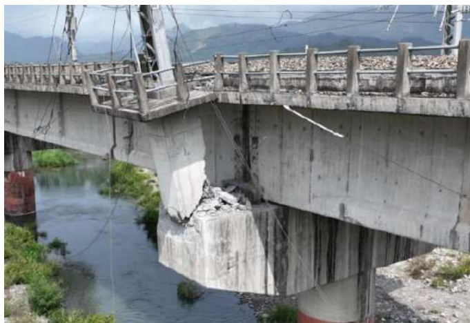
圖4-1 新秀姑巒溪橋震後受損狀況(P9橋墩西側)
