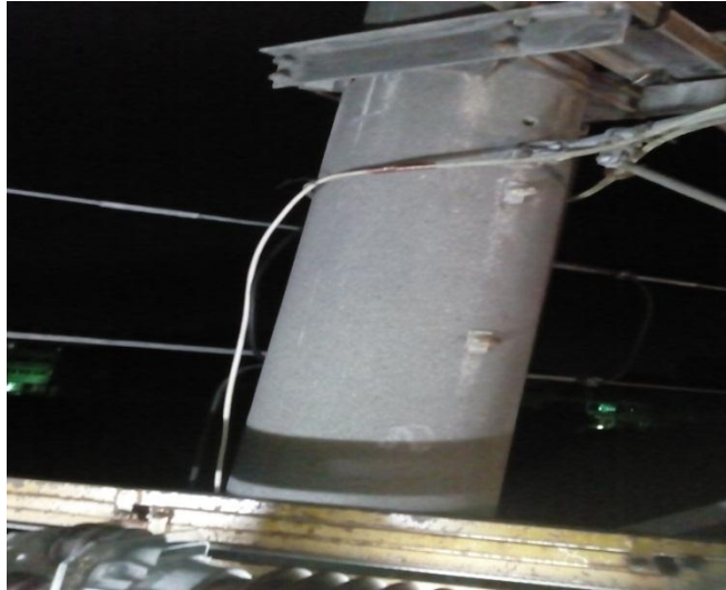
圖 7 彰化變電站 N/S 未切 PLB 告警系統回流線接線相片
