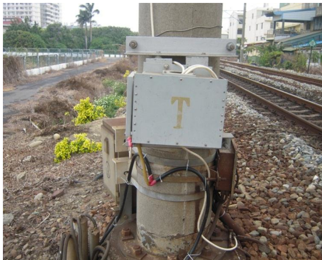
圖 8 彰化變電站 N/S 未切 PLB 告警系統 CT 相片
