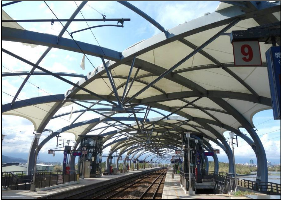
圖 1.1 冬山站薄膜破損情況(1)
