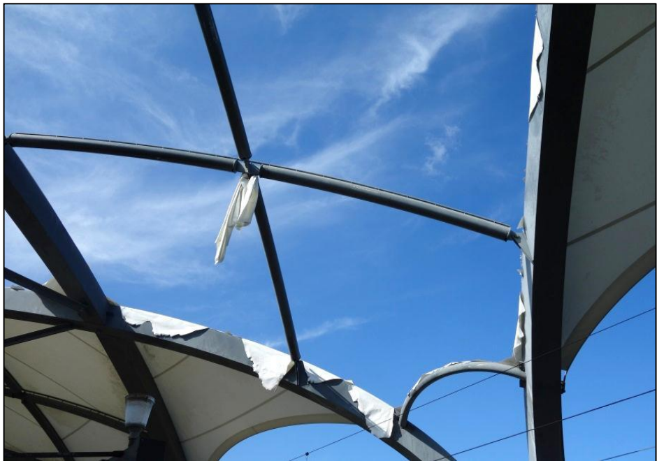
圖 1.2 冬山站薄膜破損情況(2)
