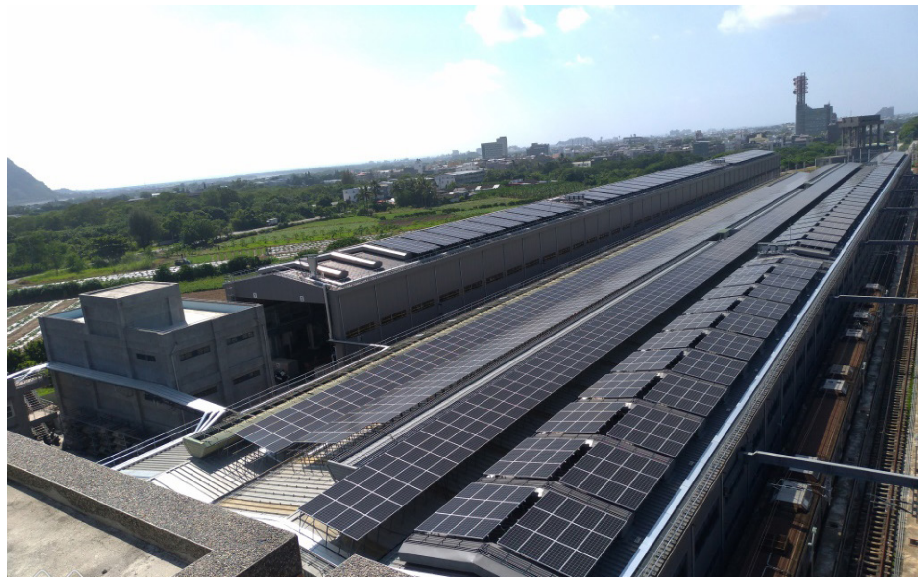
臺東機務分段維修車庫屋頂太陽光電設備
