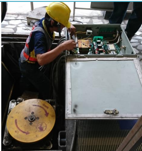
圖 3-15 花蓮電扶梯上機坑
