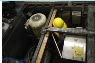
圖 3-6 板橋電扶梯上機坑
