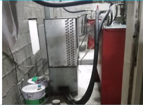
圖 3-11 新左營電梯機房
