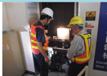
圖 3-8 竹南電梯昇降道
