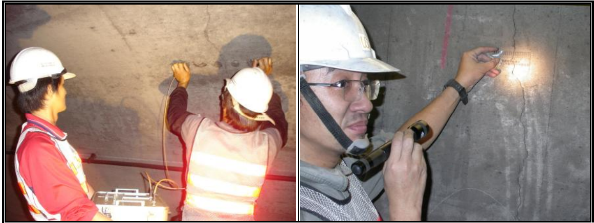
圖 3.7-1 裂縫深度及寬度檢測實況
