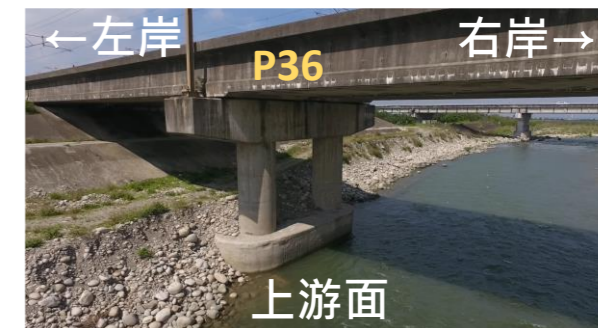
P36基礎裸露深度約3.98m
