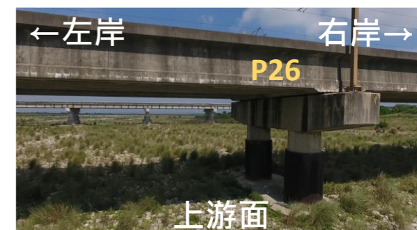
P26基礎裸露深度約1.87m
