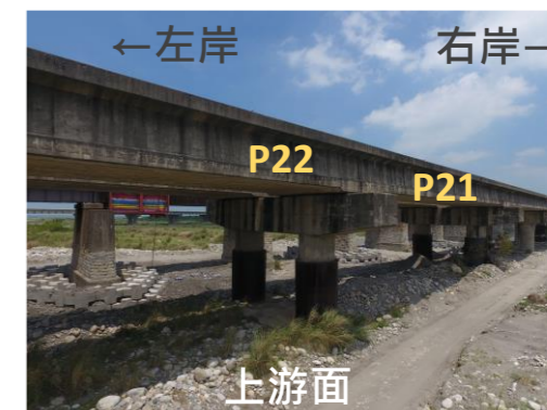
P22基礎裸露深度約0.58m
