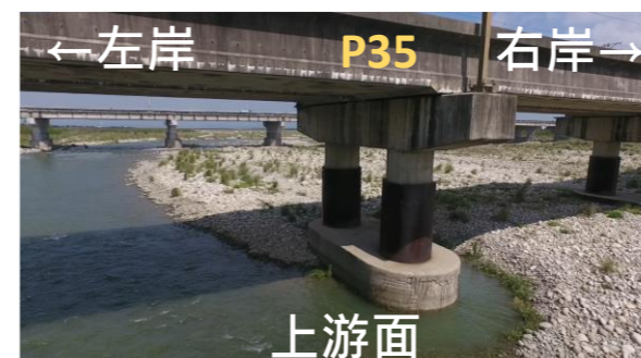
P35基礎裸露深度約2.31m
