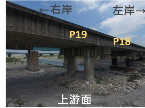
P19基礎裸露深度約1.80m
