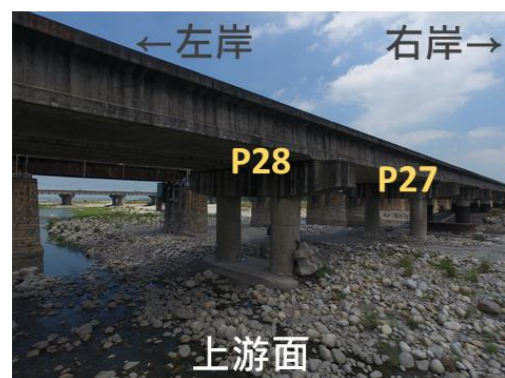
P28基礎裸露深度約0.83m
