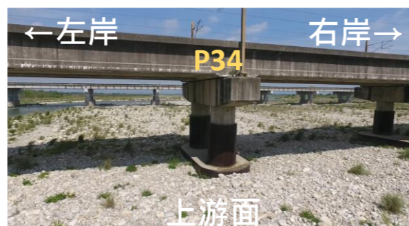
P34基礎裸露深度約2.30m
