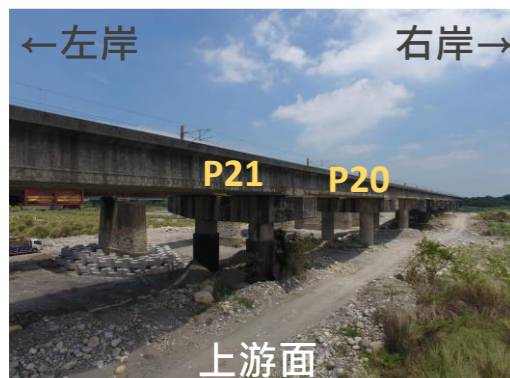
P21基礎裸露深度約0.51m
