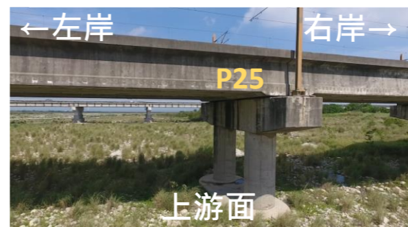
P25基礎裸露深度約2.87m
