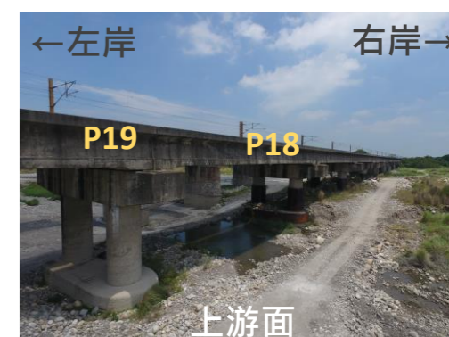
P18基礎裸露深度約1.07m
