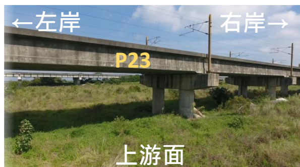
P23基礎裸露深度約2.07m
