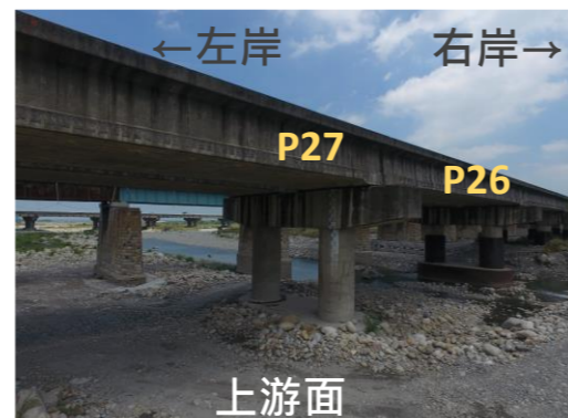
P27基礎裸露深度約1.66m
