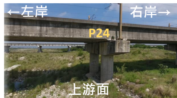
P24基礎裸露深度約2.43m
