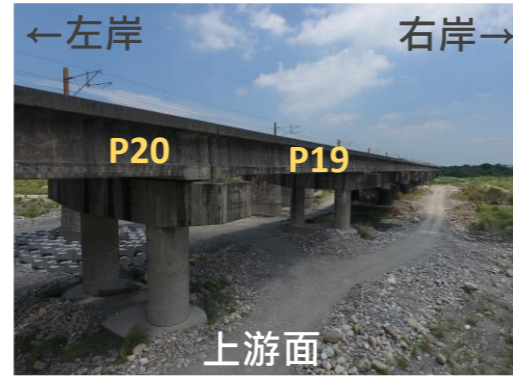
P20基礎裸露深度約0.52m
