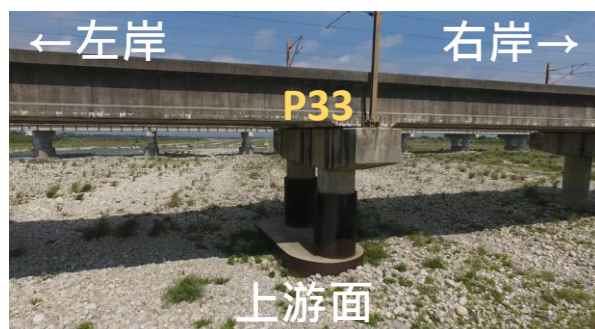
P33基礎裸露深度約2.08m
