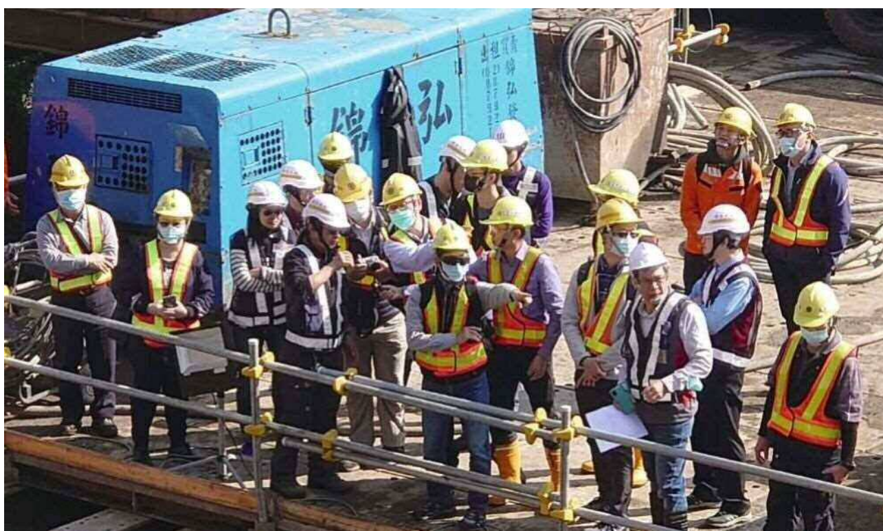
▲現場會勘討論邊坡滑落可能之破壞模式及破壞面
