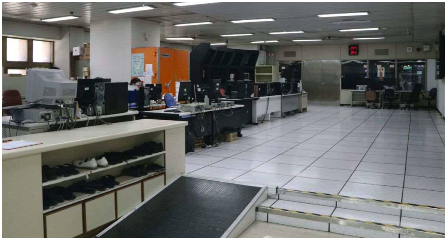
▲資訊中心機房控制中心
