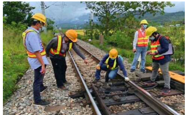
▲賈主任召集相關單位辦理池上站 11 號轉轍器鎖定桿與枕木相衝突會勘（東區協調中心）
