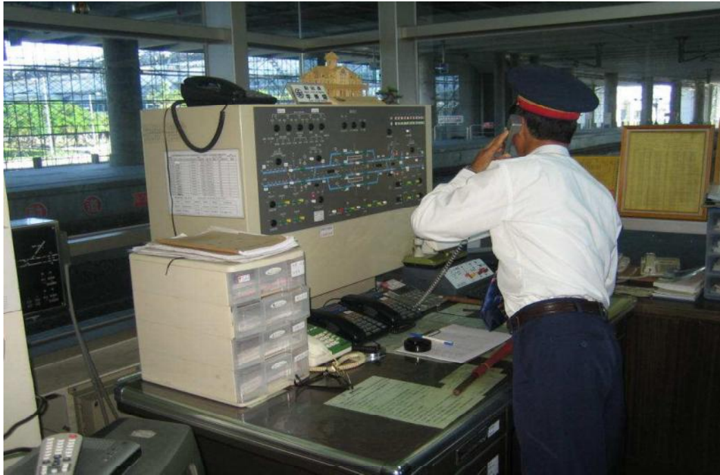
【值班站長確認出發號誌機故障】
