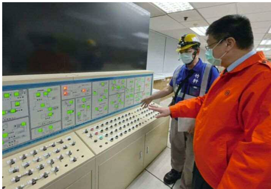
▲局長視察工務台軌道通道通風監控設備
