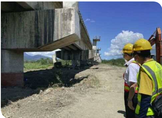
▲臺東工務段長楊崑宗陪同局長視察新秀姑巒溪橋損壞情形
