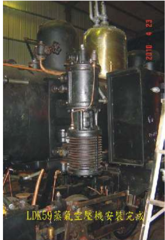
LDK59蒸氣空壓機安裝完成
