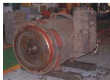
發電機及各項電器配件
