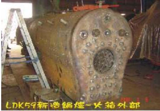
LDK59新造鍋爐－火箱外部
