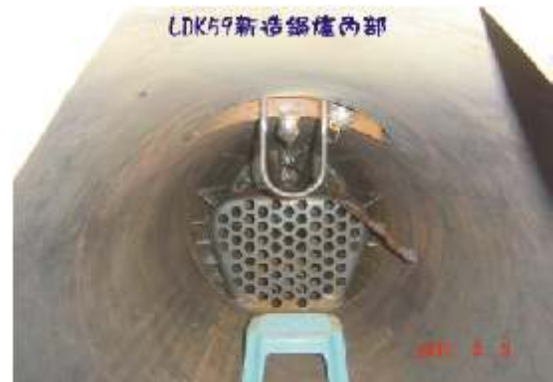
LDK59新造鍋爐內部
