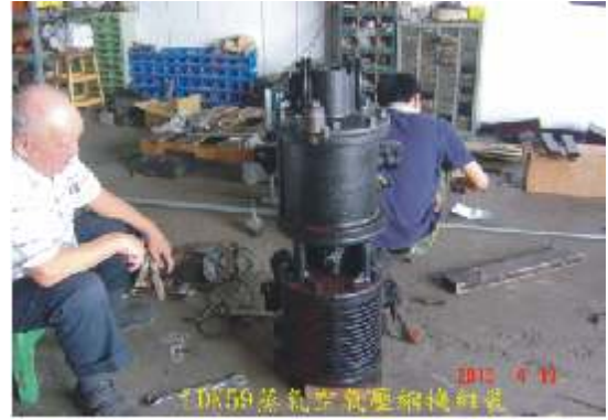
LDK59蒸氣空氣壓縮機組裝
