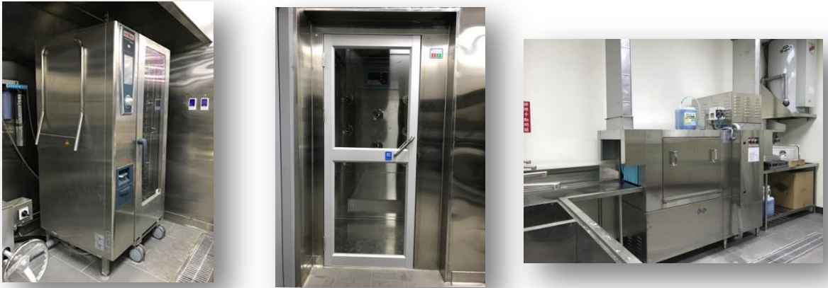
圖 15 臺中餐務室新式設備
