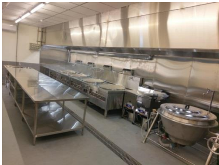
圖 18 臺東餐務室烹調區新設備
