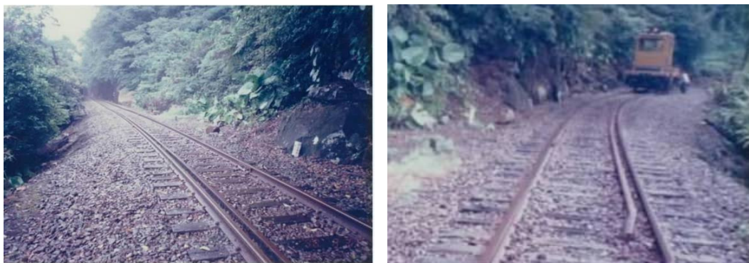
圖 2 防脫護軌照片（37 kg/m 鋼軌及木枕軌道）
